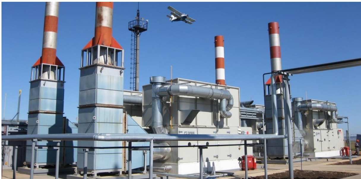
Пример энергоцентра наружного исполнения
