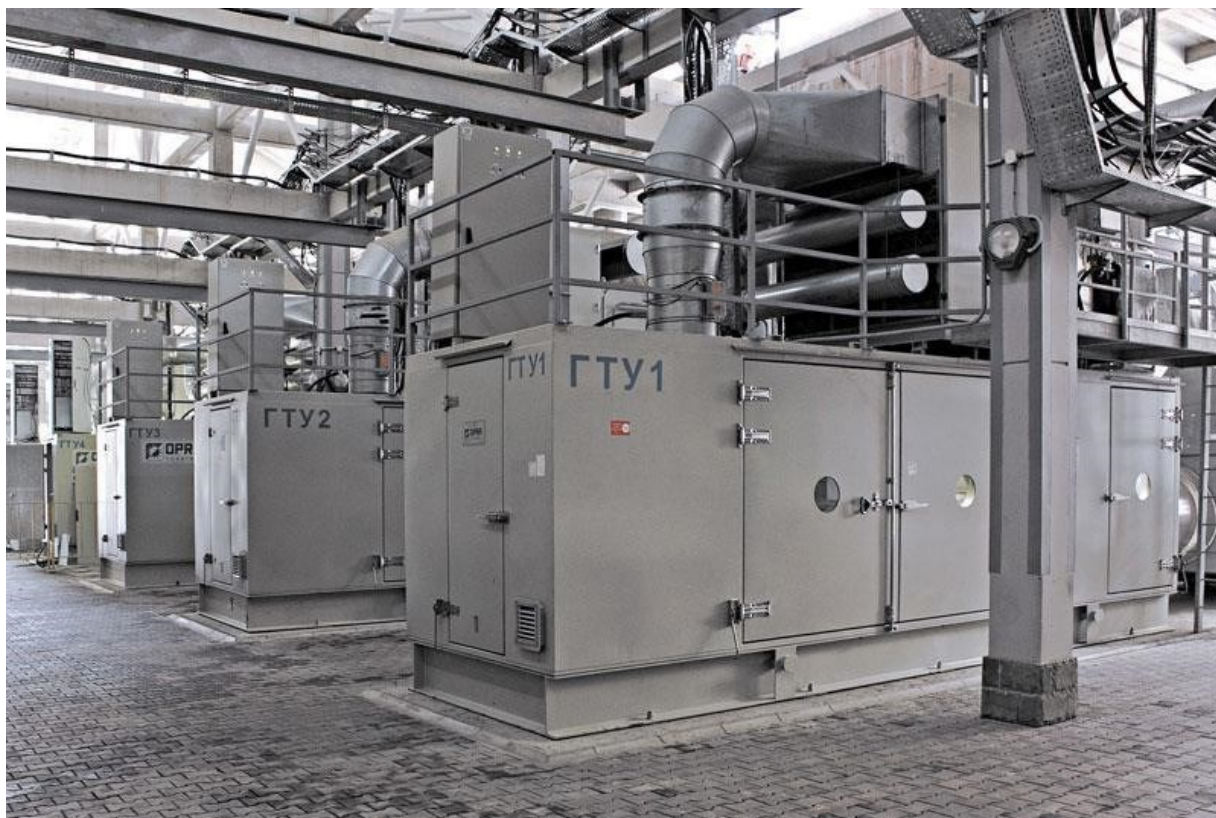
Пример энергоцентра внутреннего исполнения
